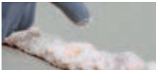
Lijmlaag barst open bij aanraking, te vroeg
